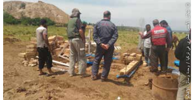
خضعت عيّات من المبانى للاختيار في تدريب المدربين. وضمن التنسيق والتعاون الوثيق مع المنظمات المحلية نقل المعرفة وسمح لها بالمضي فتماً وتنفيذ مشاريع مماثلة في المستقبل.
