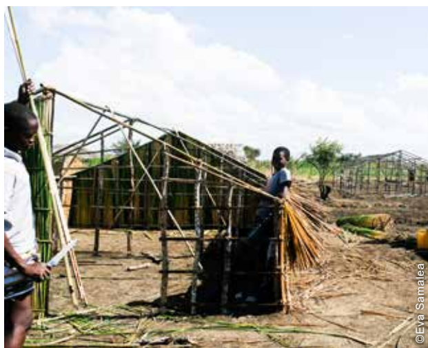
Foi prestado apoio às famílias que construíam os seus próprios abrigos com materiais disponíveis localmente. Estes esforços incluíam sessões de formação e sensibilização sobre técnicas de construção mais resistentes e mitigação dos potenciais impactos negativos da construção de abrigos.
